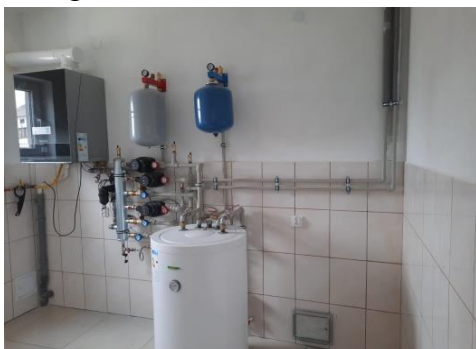
Kotłownia w świetlicy wiejskiej w Uścieńcu
