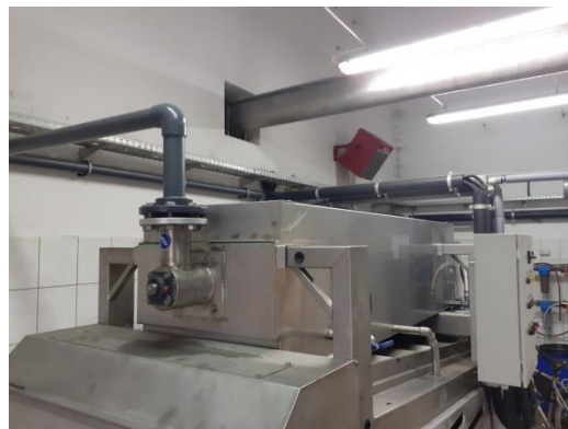
Zakupione wyposażenie w oczyszczalni ścieków w Nowym Pilczynie
