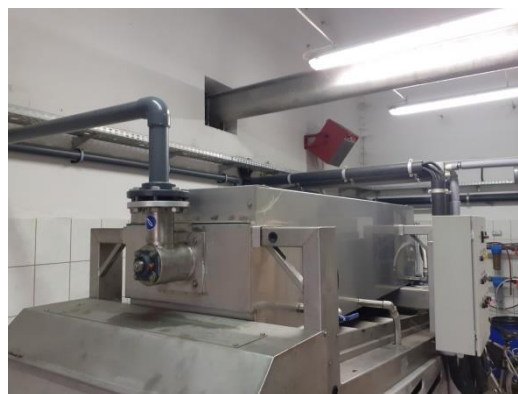
Zakupione wyposażenie w oczyszczalni ścieków w Nowym Pilczynie
